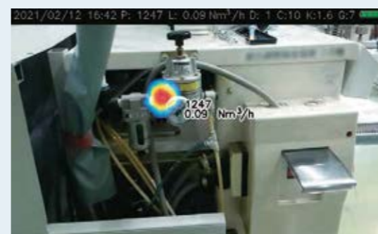
配管などのガス漏れを即発見
