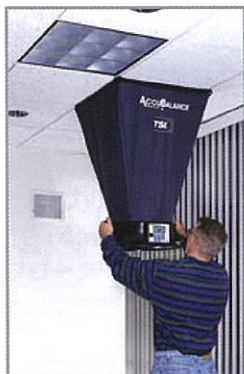
アネモ吹出、吸込測定例
